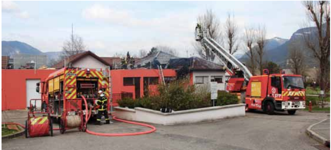
Les flammes se sont concentrées sur la partie de la toiture qui couvre le hall d'accueil de la MSF. Les autres parties de l'équipement ont été épargnées.
